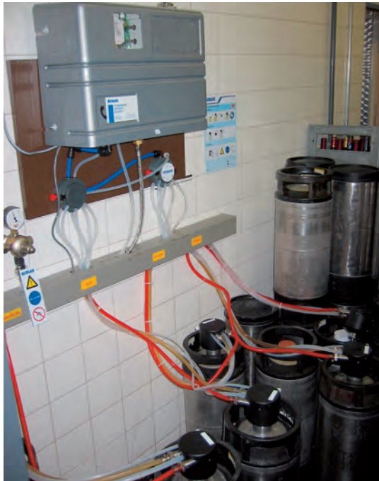
Abb. 5: Automatisches chemisches Reinigungsgerät für Getränkeleitungen (Dosiervorrichtung und Steuereinheit)
